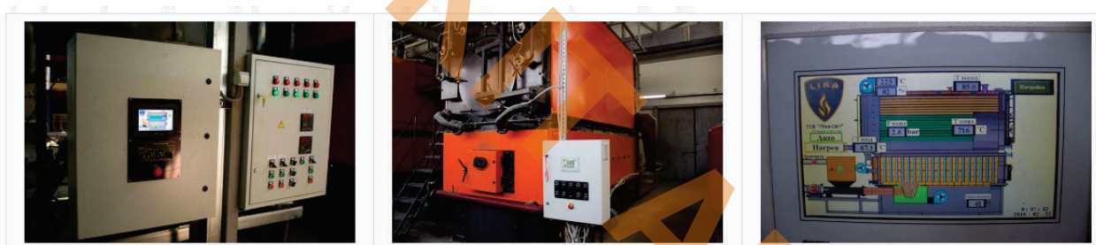
Рисунок 1.6 – Автоматизована котельня на твердому паливі [4]
