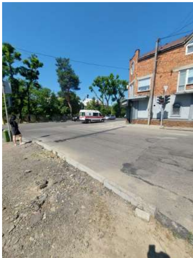
Рис. 1.5 : незадовільний стан тротуару біля пішохідного переходу (ТЦ Дастор )
